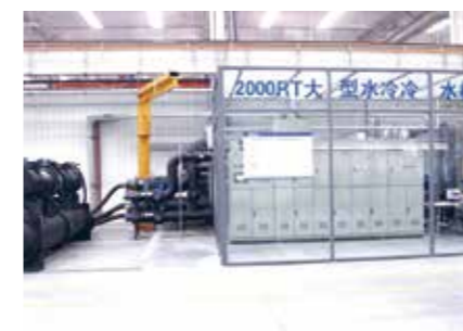
Лаборатория для проверки чиллера водяного охлаждения до 2000RT (7034кВт)
