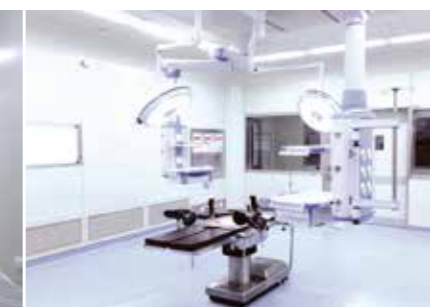
Системы очистки воздуха в операционных
